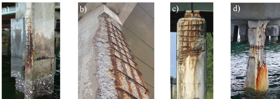
Rys. 1. Uszkodzenia korozyjne słupów żelbetowych: a) https://www.wesavestructures.info/corrosion-evaluation (31.01.2022 r.), b) https://www.fprimec.com/structural-effects-corrosion/ (31.01.2022 r.), c) https://www.theengineerincommunity.org/types-and-causes-of-concrete-deterioration/ (31.01.2022 r.), d) https://www.techdry.com.au/how-to-avoid-salt-water-corrosion-within-reinforced-concrete/ (31.01.2022 r.).
